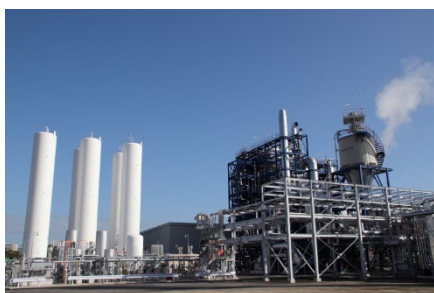
岩国事業所に新設した自家火力発電所
