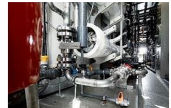
Salt Power社の浸透圧発電プラント
