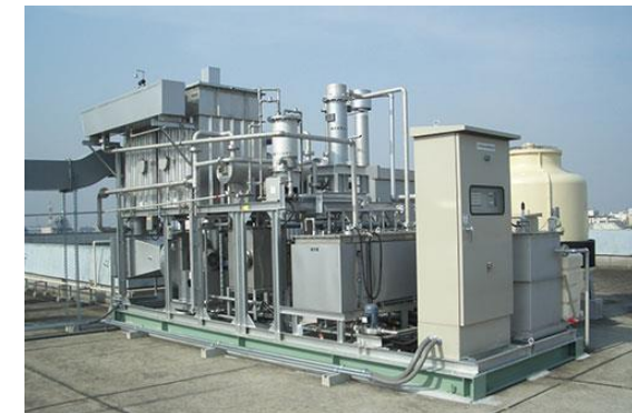
VOC回収装置
