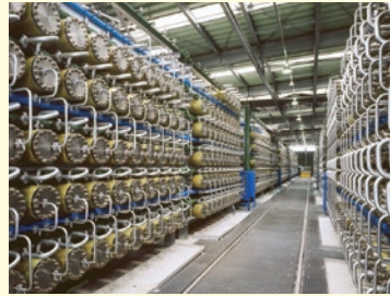
海水淡水化プラント
