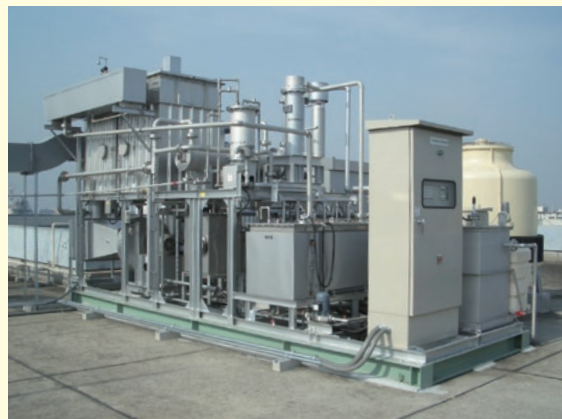
VOC回収装置
